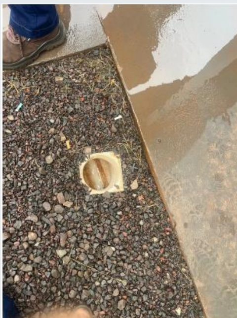
Fotografia 08: Cano para drenagem sem proteção
